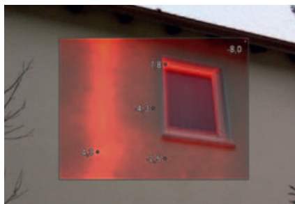
Temperaturmessung zur Feststellung von Wärmeverlusten in einer Hausfassade.
